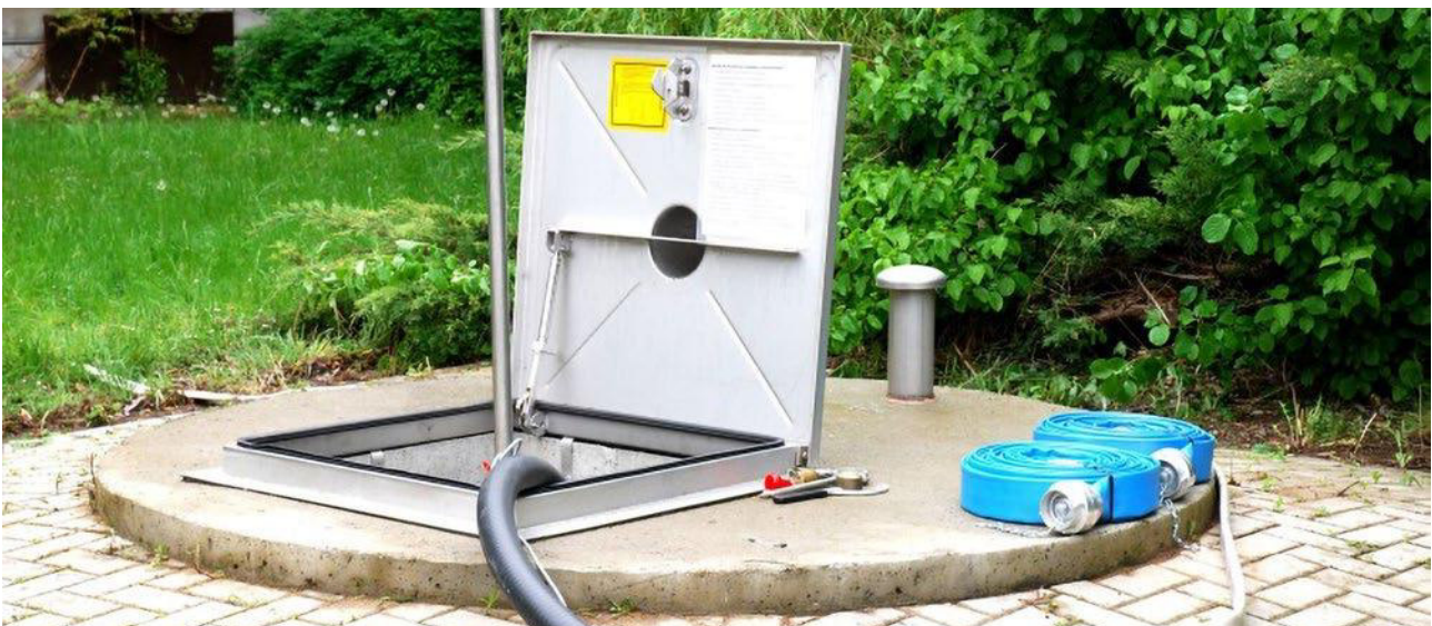
Abbildung 19: Beispiel eines Trinkwassernotbrunnens als Beispiel eines leitungsunabhängigen Brunnen (Bildquelle: P. Fischer, BBK)
