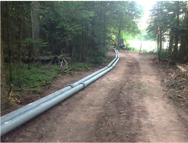
Abbildung 21: Ersatz- oder Notversorgung über mobile Leitungen (Bildquelle: Merbs, 2018)
