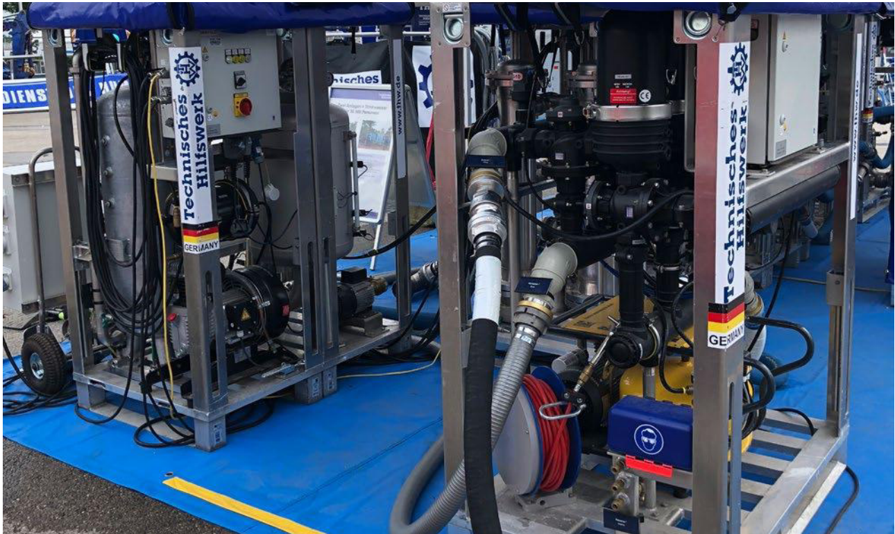
Abbildung 20: UF-15 Anlage des THW (Bildquelle: SWA)
