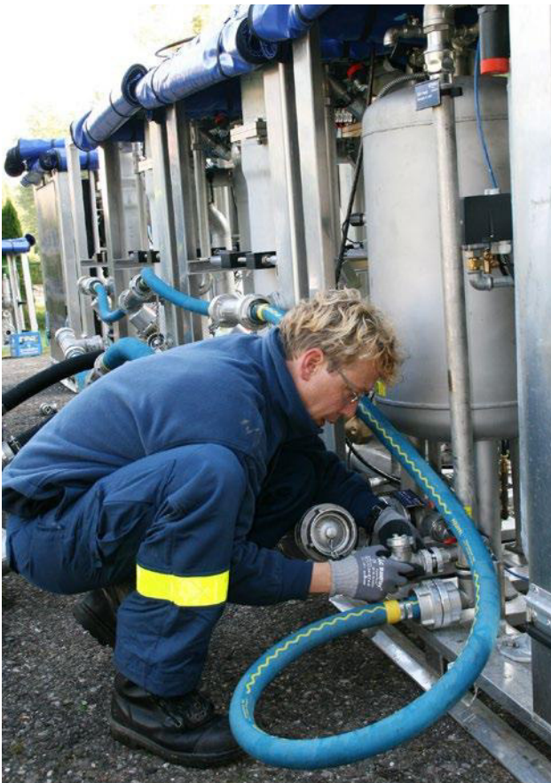
Abbildung 5: Fachgruppe Trinkwasser betreibt Trinkwasseraufbereitungsanlage UF-15 (Bildquelle: THW)
